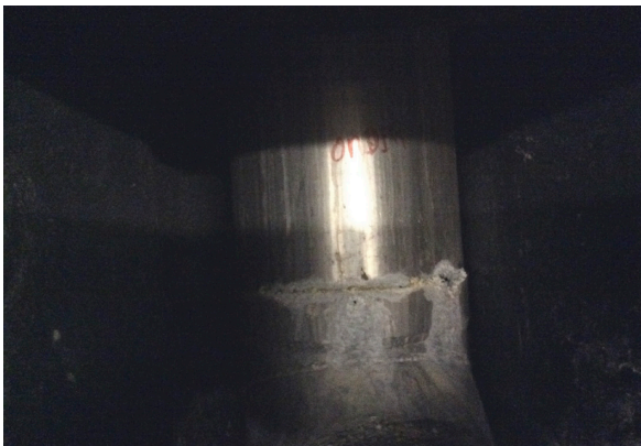
Lekkage door corrosie
